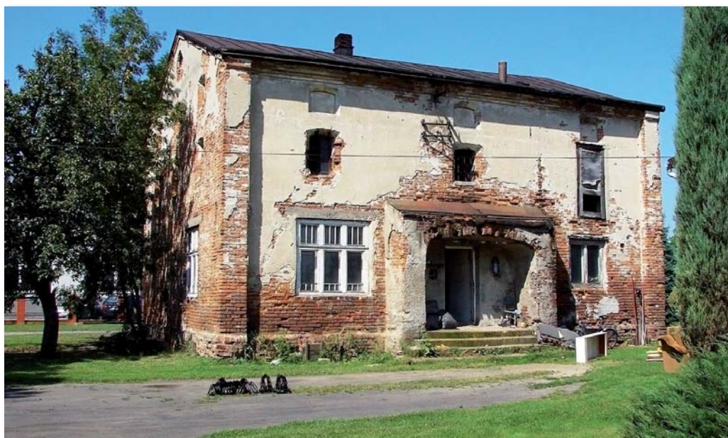
W takim stanie pozostaje najstarszy obiekt na terenie sołectwa. To dawny spichlerz trzebownickiego folwarku. Powstał na początku XIX wieku. Po II wojnie pełnił różne role: jako budynek gospodarczy, mieszkalny, a nawet usługowy (fryzjer).
